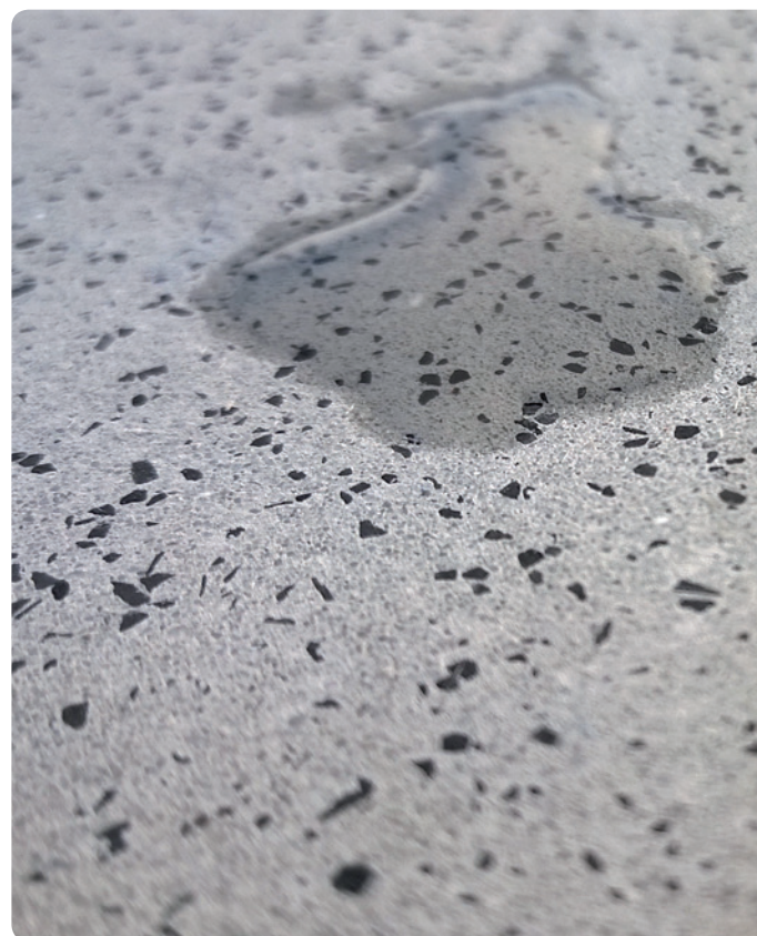
Onbehandelde beton – Water dringt in de beton
